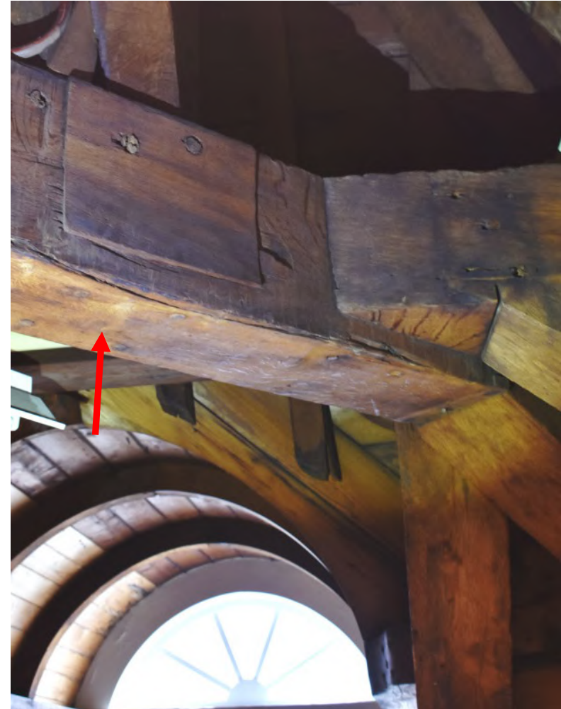
Gebint 15, ontmoeting hoekkeper met gebint 14 en 16 inzetstuk in dekbalk met toognagels aan de onderzijde
