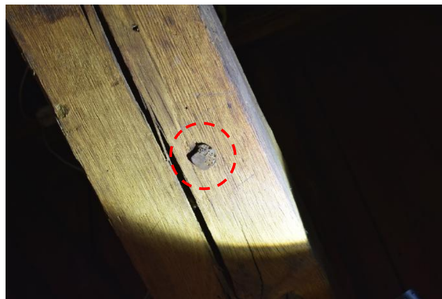
Afb.3.68 Dichtgezet vlotgat (?) in spantbeen
