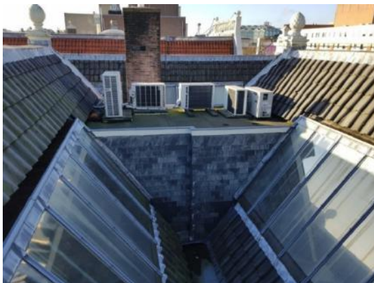
Afb. 3.04 Binnenste dakschilden gezien richting zuiden
