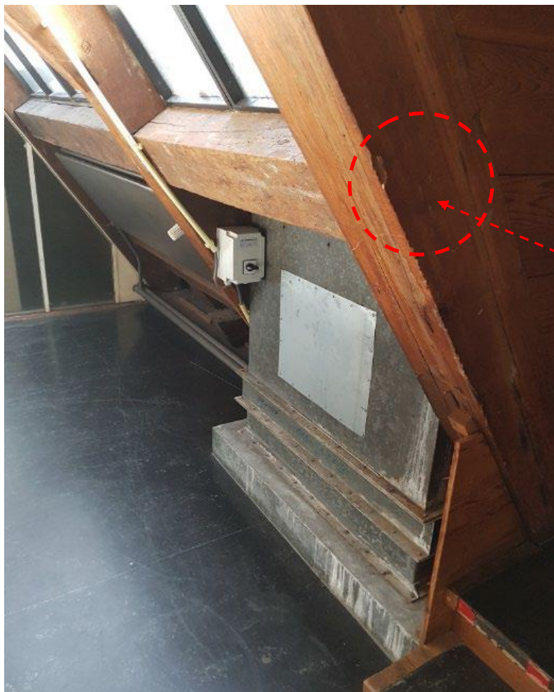
Afb.3.79 Spantbeen van gebint 02 bevat in tegenstelling tot het overgrote deel van spantbenen geen dichtgezette gat ter hoogte van de gordingen. Zie uitleg hoofdstuk 3.9
