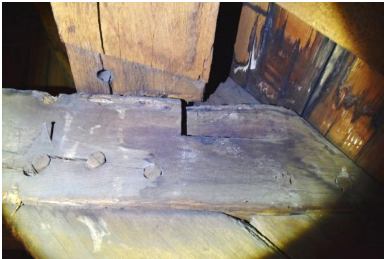
Halfgebint 29 bovenhoek dekbalk met zwaluwstaart Erboven huidige flieringbalk met zwaluwstaart in tegenovergestelde richting
