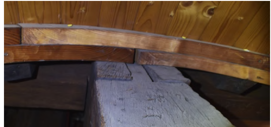
Afb.3.35 Zichtbare open pen-en-gatverbinding (achterzijde spantbeen gebint 23)
