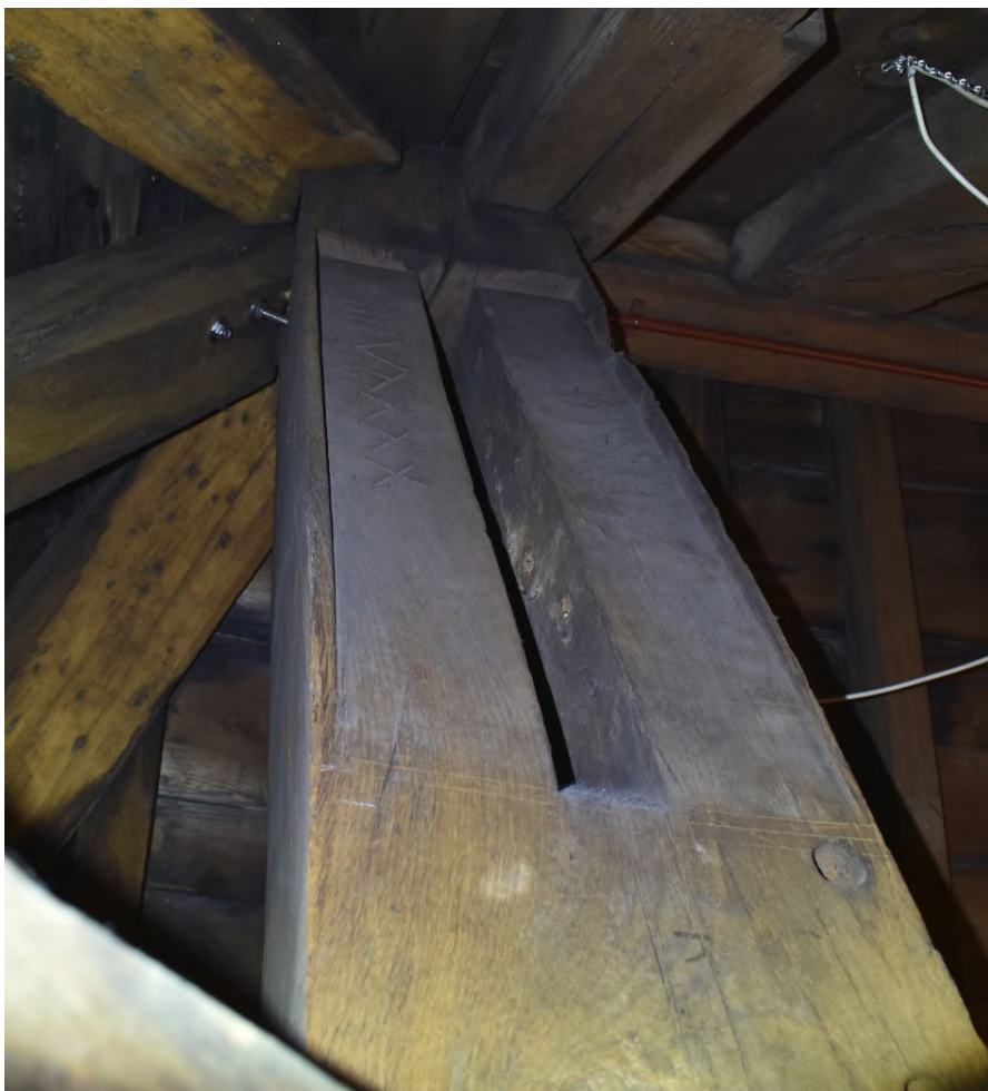
Links Afb.3.32 Koningstijl ter plaatse van ontmoeting lange met korte dakschilden Rechts Afb. 3.33 Horizontaal dakbeschoot op sporen
