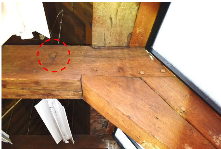
Afb.3.66 Dichtgezet vlotgat(?) in dekbalk
